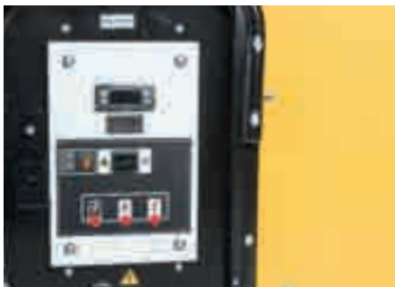
Автоматический контроль горения. Панель управления позволяет задать цифровые параметры
